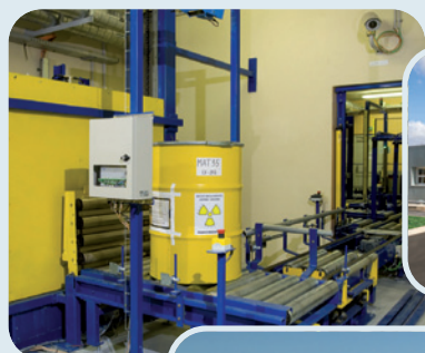
ROTONDE : tri et expédition de colis de déchets de faible et de très faible activité
